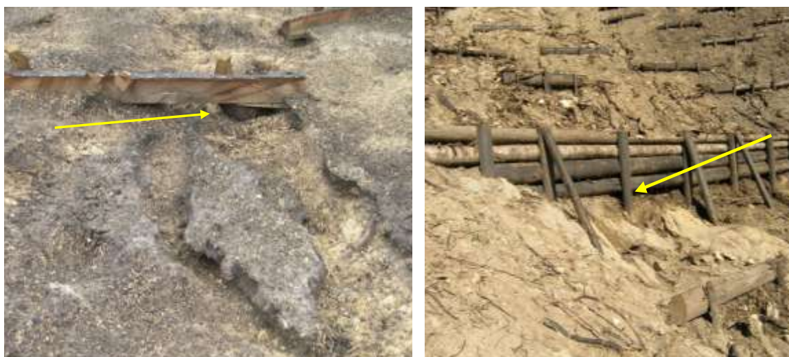
Εικόνα 3 - 2: Υποσκαφή σε κορμόδεμα (αριστερά) και αστοχία πλήρους εφαρμογής κορμοφράγματος στο έδαφος (δεξιά).
